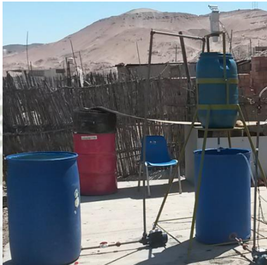
Fig. 3. 3 Los Tanques 01, Filtro 01 y Tanque 02 (Fuente: Elaboración Propia)
