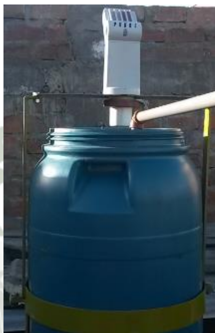
Fig. 3. 6 Montaje del Sensor de Nivel The Probe (Fuente: Elaboración Propia)
