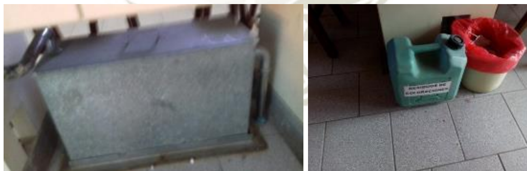
FIGURA N° 6 Trampas de grasa de los Laboratorios de microbiología y depósitos de las coloraciones recolectadas
