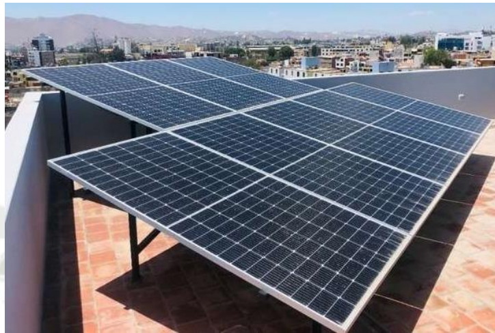
Figura 38 Paneles solares policristalinos
