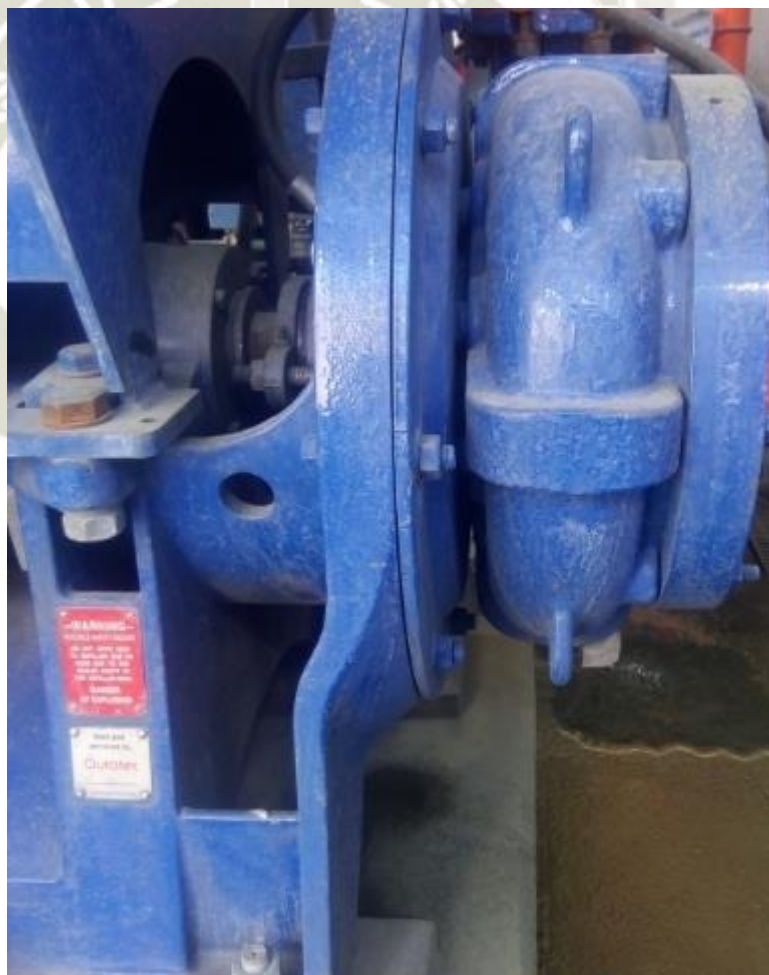
Figura 3.4. Bomba de transferencia PP-001.
