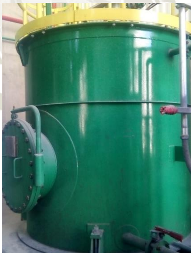
Figura 3.3. Tanque de transferencia TK-002.
