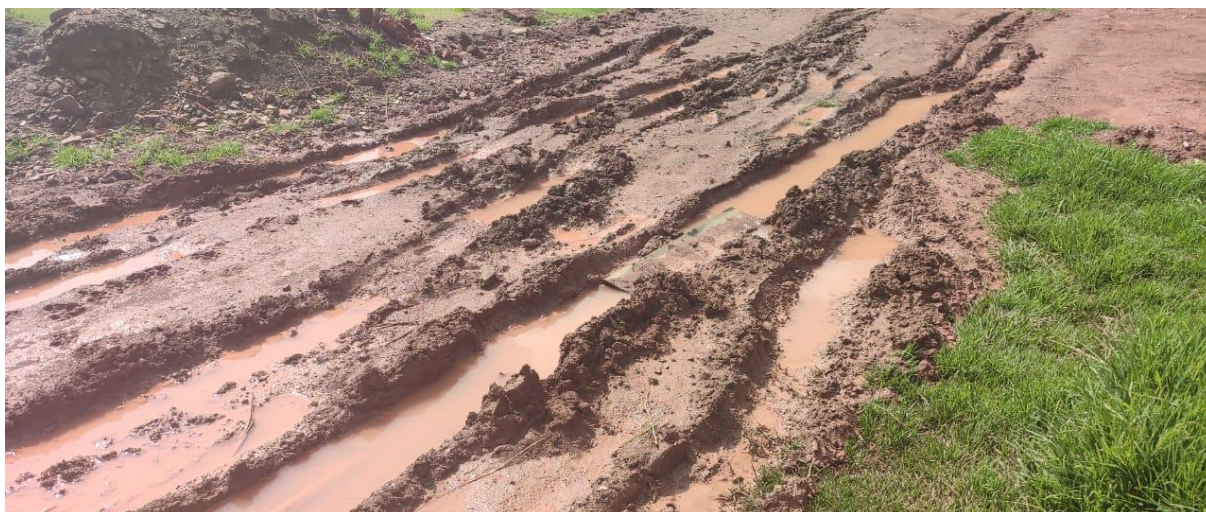
Figura 1. Observación visual de la condición de la vía de estudio, mostrando retención de agua producto de las lluvias.
