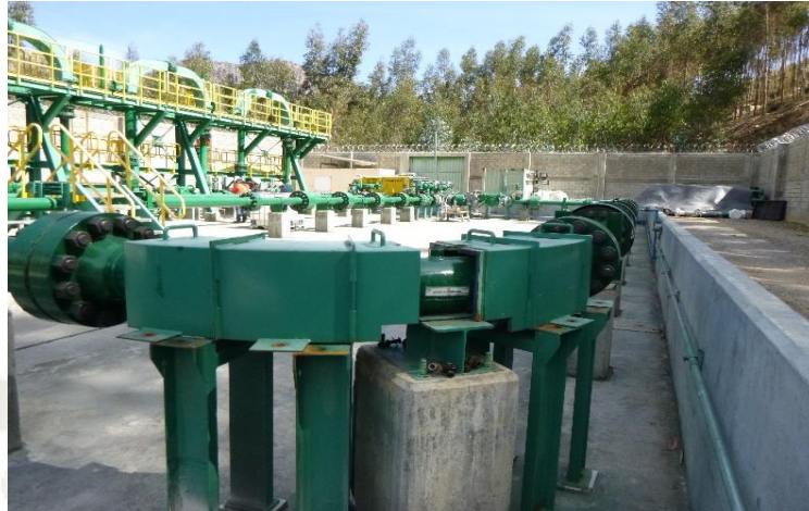
Foto 1. Estación de Válvulas VS1
