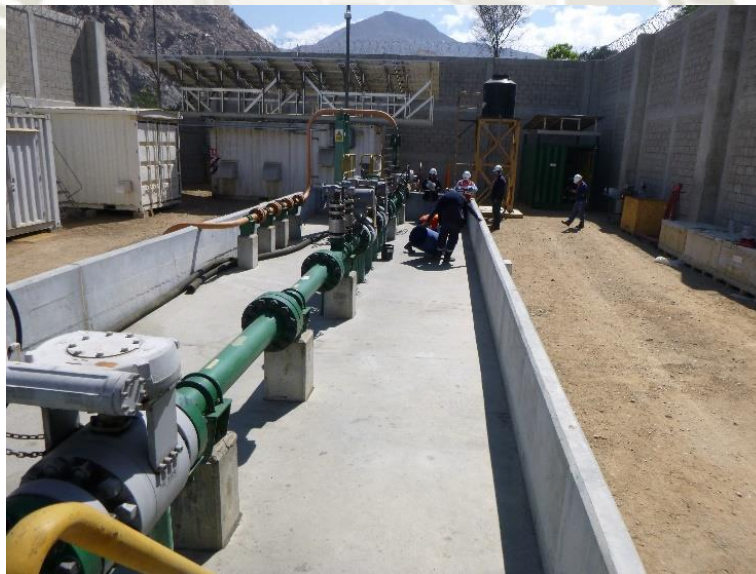
Foto 2. Estación de Válvulas VS4
