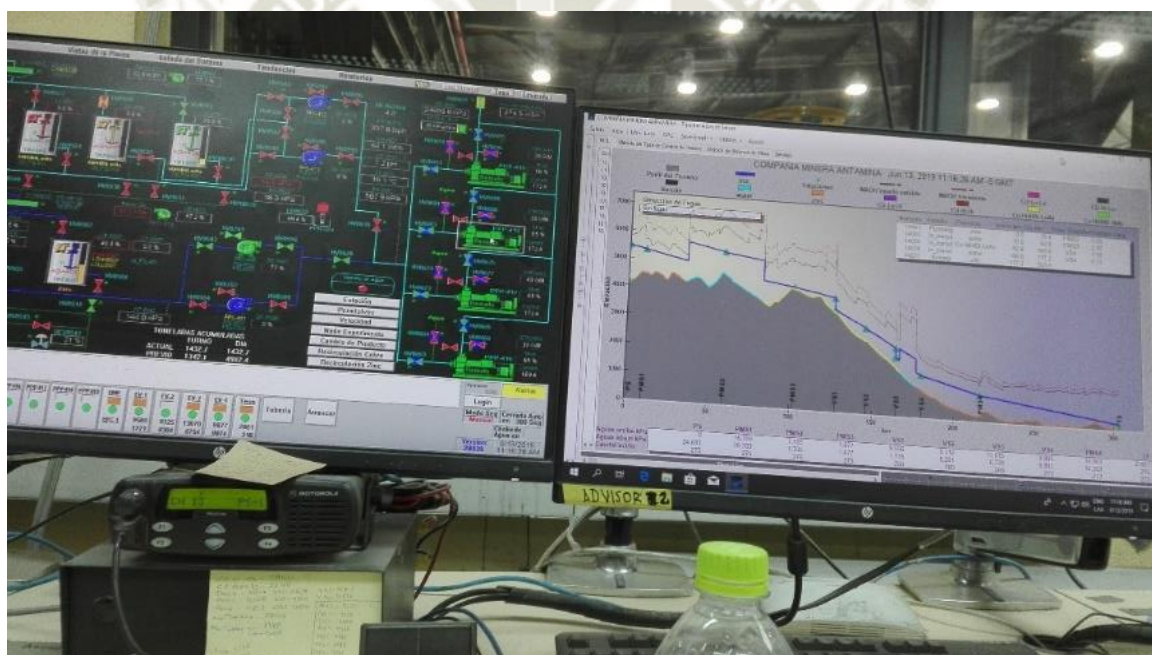
Foto 4. Sala de Control (monitoreo de presión)
