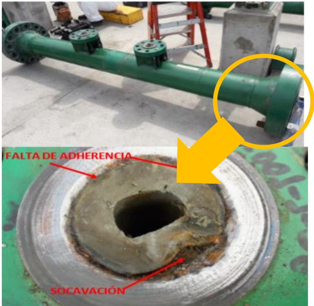
Foto 10. Socavación en Spool
