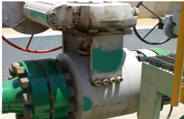
Foto 3. Válvulas en estaciones
