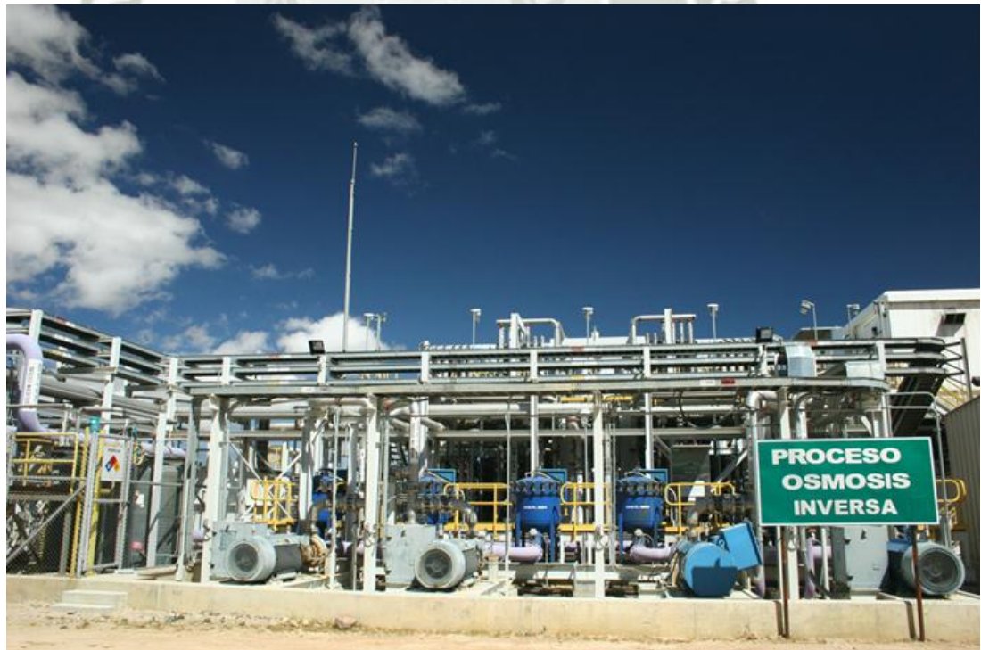
Gráfico 3.80 – Sistema de Ablandamiento de Agua
