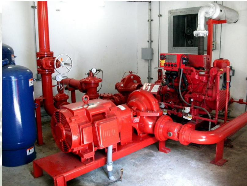
Gráfico 3.75 – Sistema de Bombeo Contra Incendios
