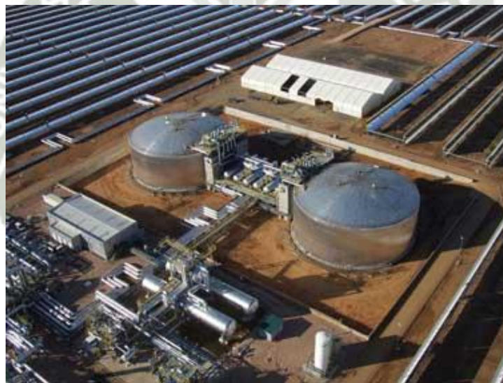
Gráfico 3.70 – Tanques de Almacenamiento de Sales
