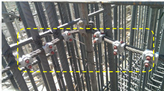
Figura 100, Línea de vida utilizada en el proyecto
