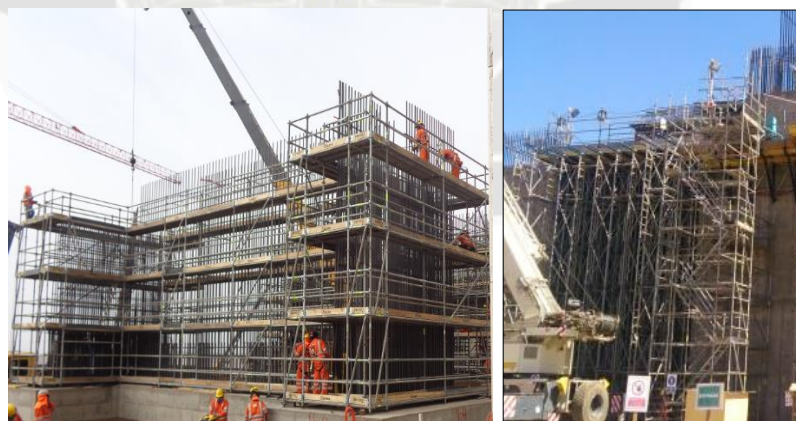
Figura 32, A la izquierda: Andamio Modular, a la derecha: Escalera Tipo Zanca
