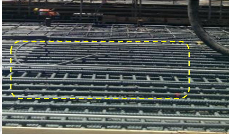
Figura 101, Losa elevada, debido a los traslapes el acero era muy congestionado, pudiendo producir cangrejeras
