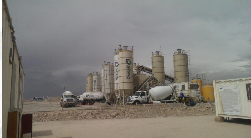
Figura 35, Planta de concreto de Supermix (Fuente: Propia)
