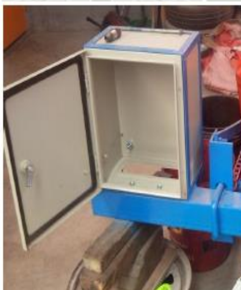
Gráfico N° 24: Tablero y panel de control
