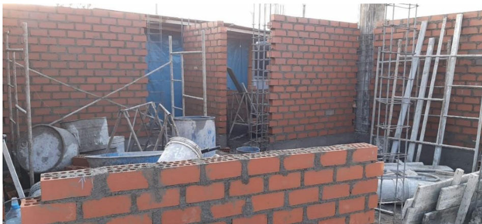
Figura 17 Procesos mal ejecutados
