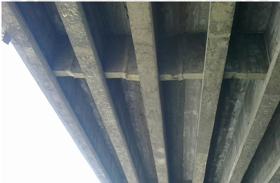
Figura 2.1.2.4 – Concreto deteriorado en vigas longitudinales y transversales
