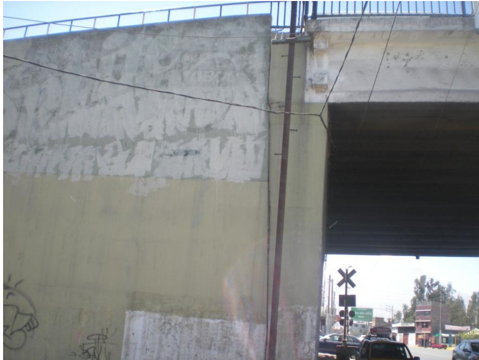
Figura 2.1.2.3 - Estribos Asimétricos y en malas condiciones
