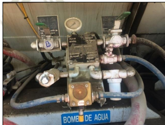
Imagen 49: Bomba de agua
