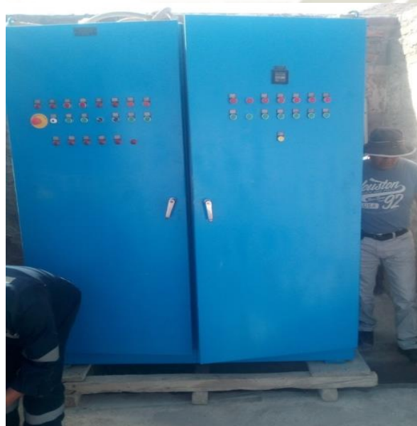
Figura 36. Tableros de Control
