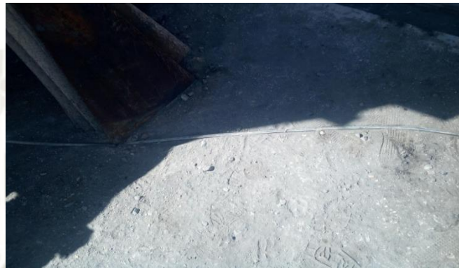
Figura 28. Cables electrificados en la planta
