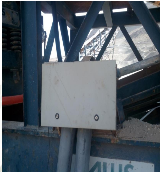
Figura 37. Tableros de Control
