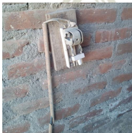
Figura 38. Palancas eléctricas de Cuchilla
