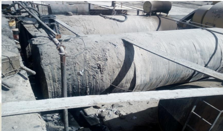
Figura 34. Tanques de almacenamiento de Líquido Asfáltico.
