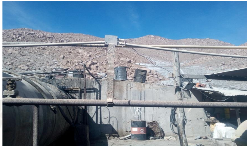
Figura 26. Tanques de almacenamiento de Líquido Asfáltico
