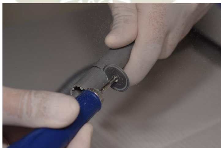
Foto N° 5: Recorte de sección de tubo PVC de 15 mm de diámetro
