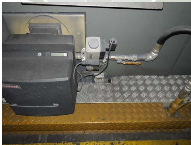
Figura 40. Tren de válvulas existente del Quemador. Fuente: Franky y Ricky S.A.
