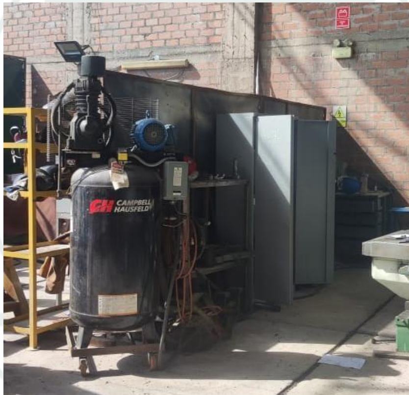
Imagen 5. En esta imagen se observa un sistema de aire comprimido industrial con los siguientes elementos:
