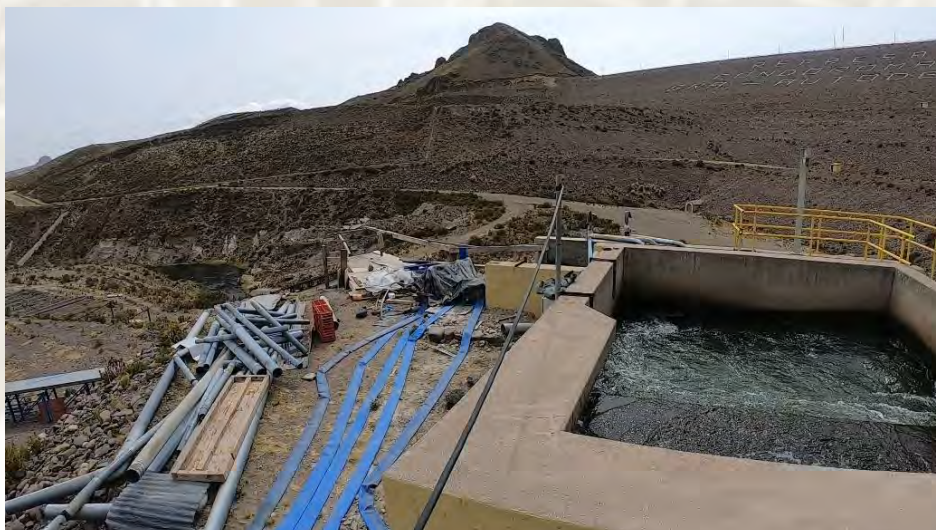
Figura36: Descripción: tubería forzada y panel de control eléctrico
