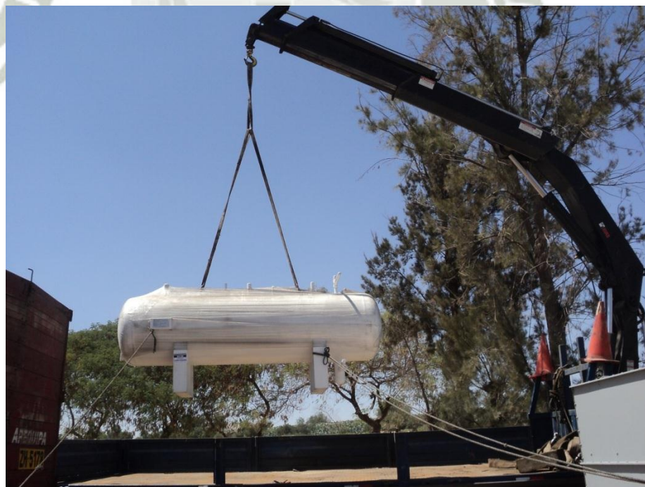
Fig. 35: Tanque receptor de líquido del Packing propuesto Fuente: Propia
