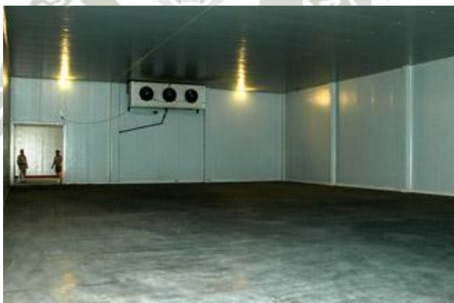
Fig. 25: Cámara mostrando el difusor de frío, elemento básico en la propagación del calor dentro de la cámara
