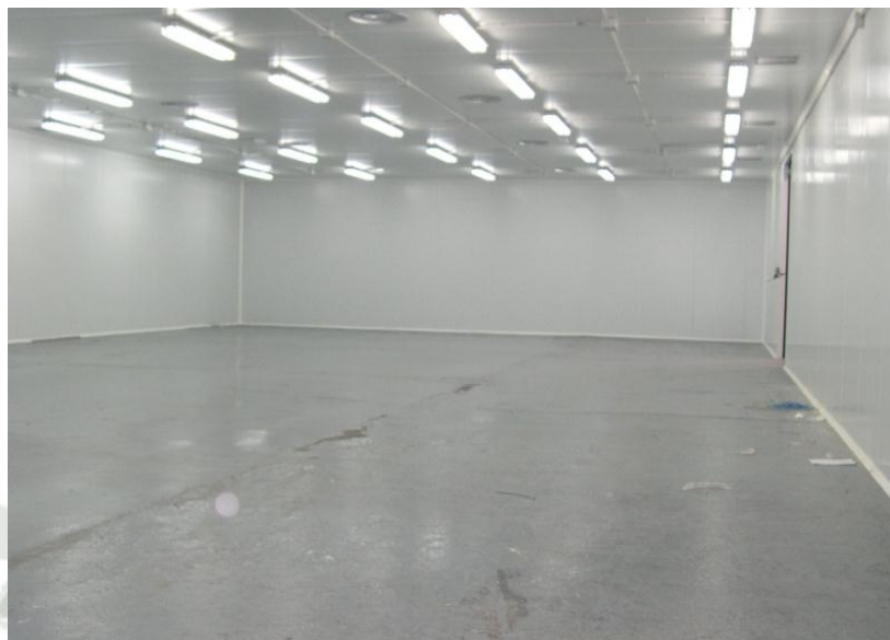
Fig. 24: Interior de una Cámara frigorífica vacía, mostrando el alumbrado con protección especial
