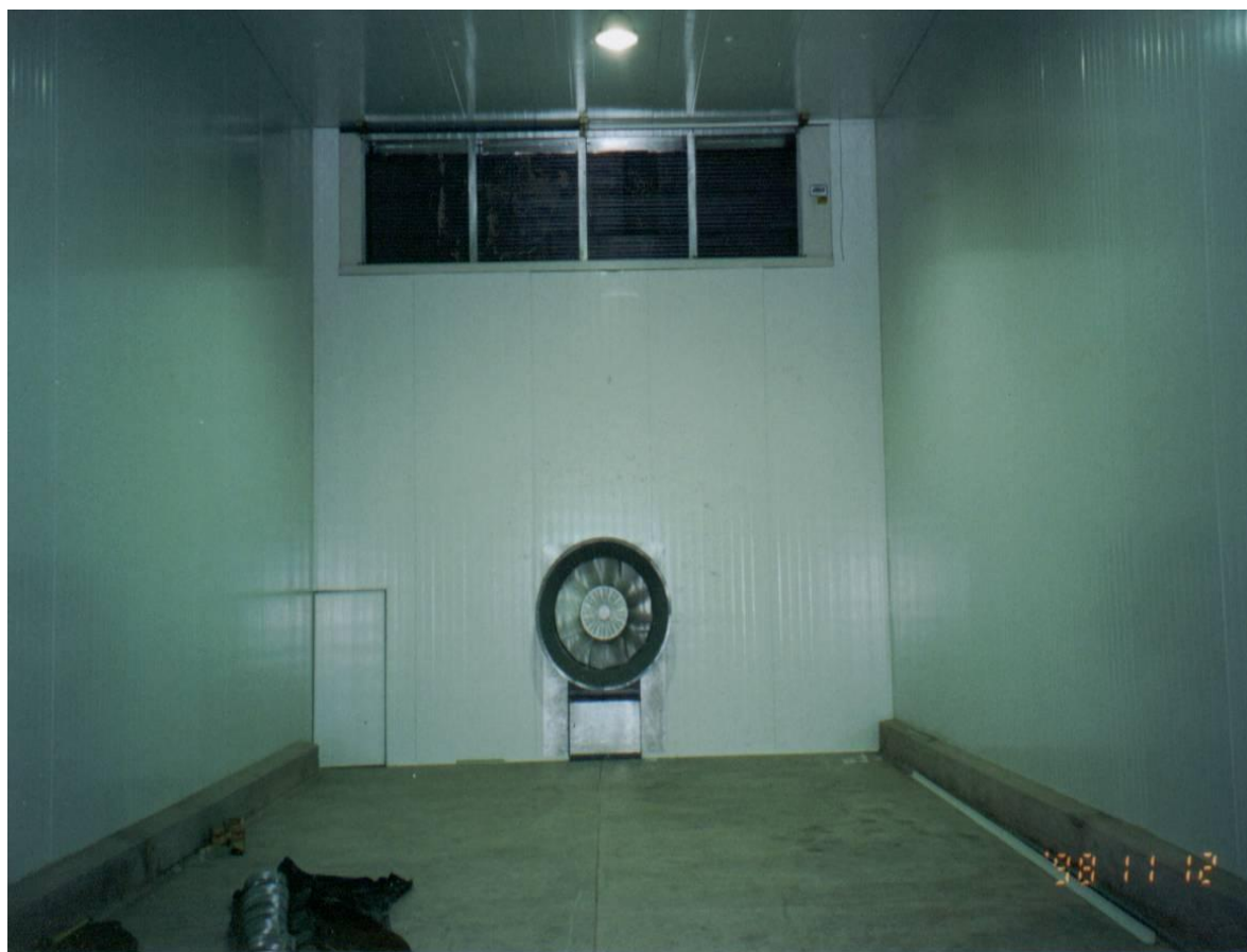
Fig.27: Vista de un Túnel de enfriamiento, se observa el ventilador de impulsión de frío y la portada de la trastienda de los rack para los evaporadores del túnel
