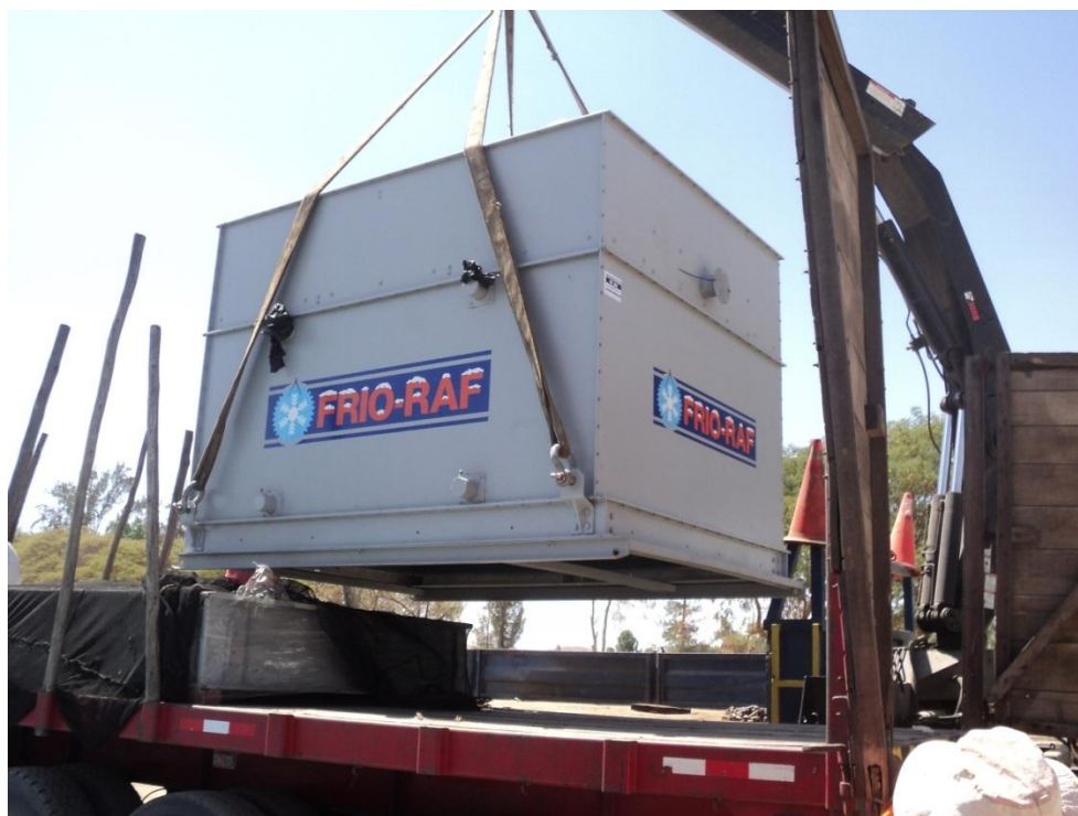
Fig. 34: Descarga del condensador evaporativo del Packing propuesto Fuente: propia
