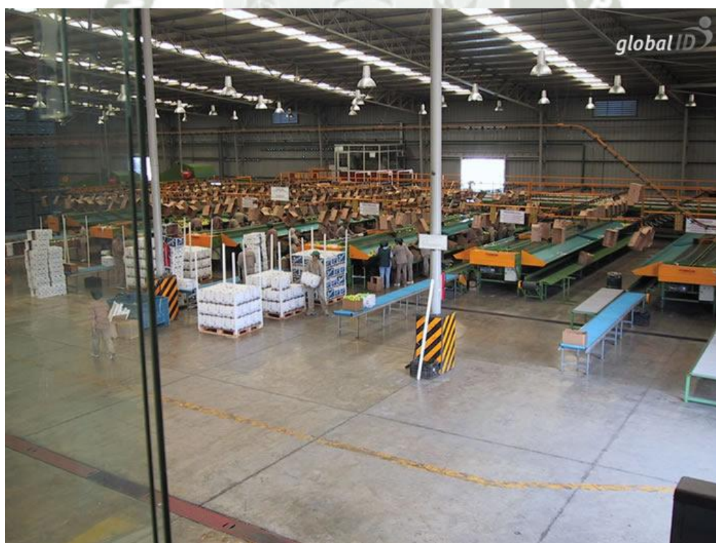
Fig. 21: Sala de Procesos de un Packing de productos agropecuarios
