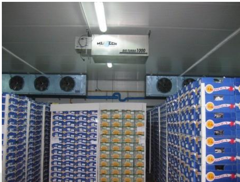
Fig. 26: Cámara cargada, mostrando los pallets con los productos refrigerados
