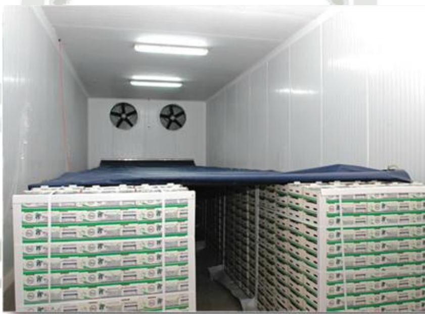
Fig. 59 Túnel de Enfriamiento
