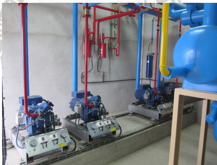
Fig. 32: Sala de máquinas, mostrando las tuberías de succión y descarga
