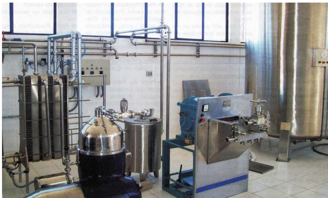
Figura N° 41 Instalación de Proceso UHT
