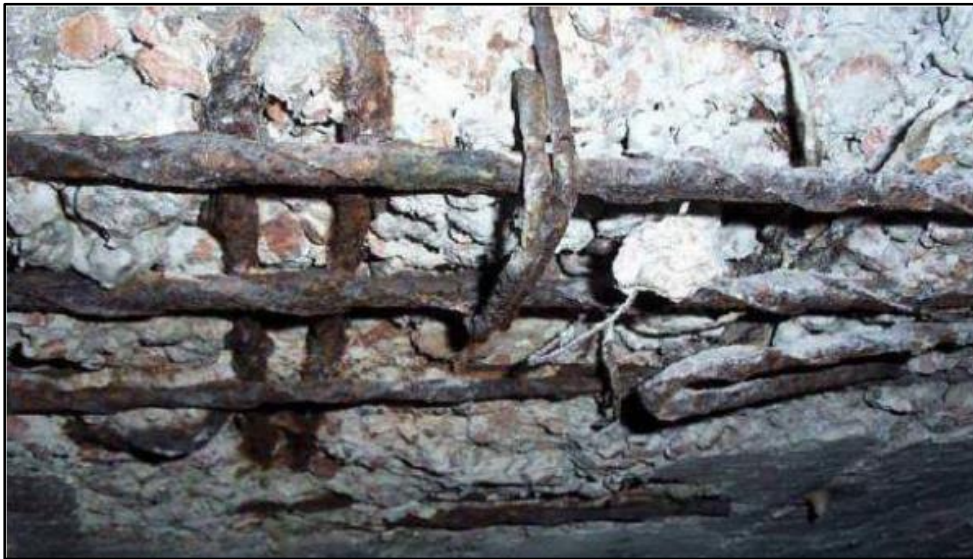
Figura 8. Daños por carbonatación del concreto.
