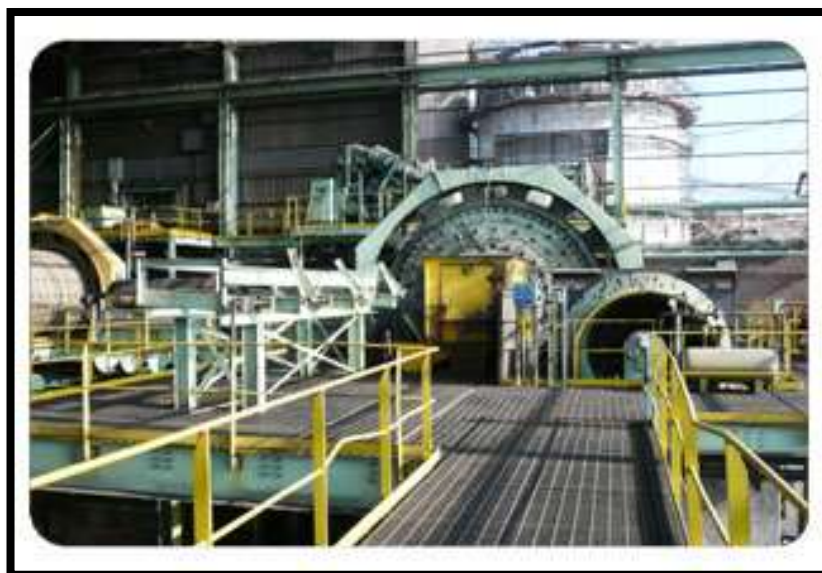
Figura 26. Proceso de Molienda
