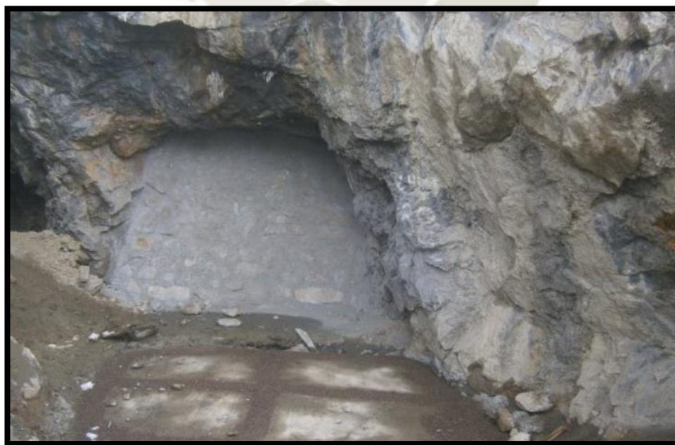
Foto N°2: Bocamina clausurada mediante un muro de seguridad de concreto que evitará el ingreso de personas y animales
