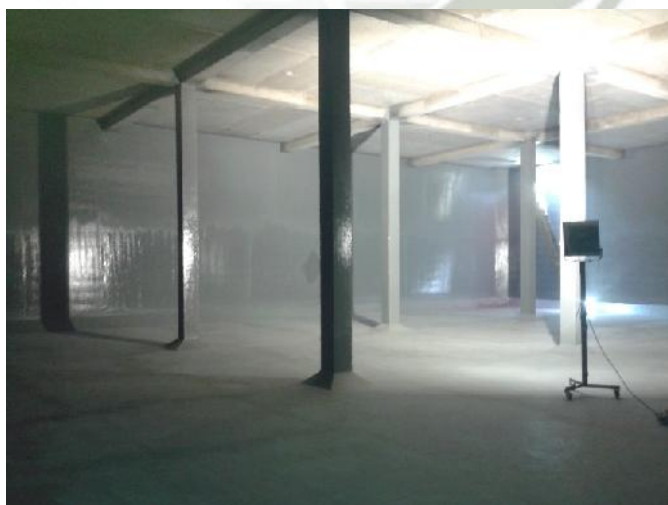
Depósito de agua tratada
