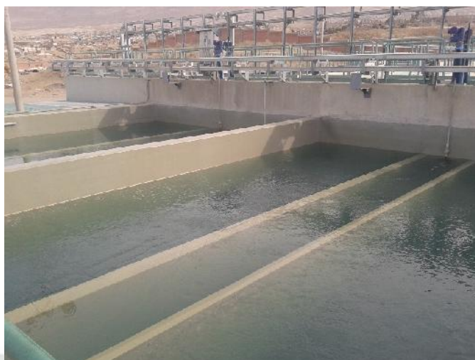
Filtros de arena
