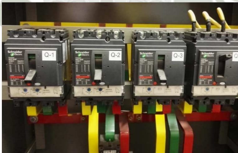
Figura 42: Vera, C. (2017). Interruptores Termomagnéticos Tripolares NSX 250F Schneider Electric. [Fotografía]. Subestación de Tecsup – Arequipa.
