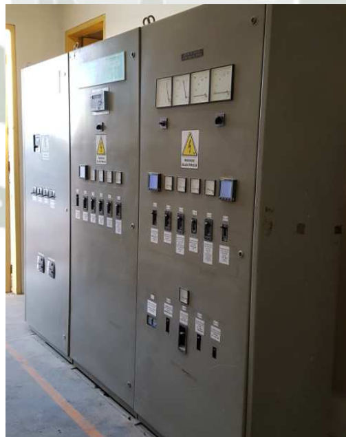
Figura 5: Vera, C. (2017). Celdas de Distribución en Baja Tensión. [Fotografía]. Subestación de Tecsup – Arequipa.
