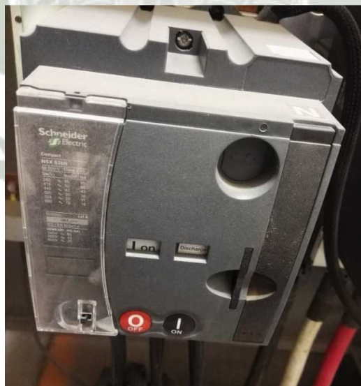
Figura 40: Vera, C. (2017). Interruptor motorizado Compact NSX 630N Schneider Electric. [Fotografía]. Subestación de Tecsup – Arequipa.
