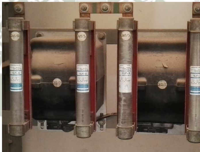
Figura 37: Vera, C. (2017). Transformadores de Tensión inductivos 10000/120 V. [Fotografía]. Subestación de Tecsup – Arequipa.
