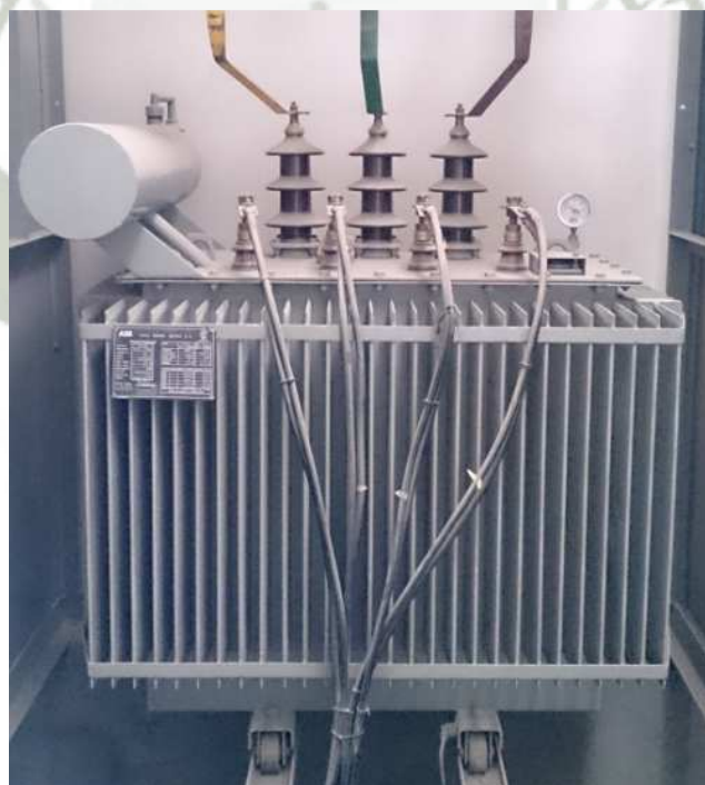
Figura 3: Vera, C. (2017). Transformador de Distribución de Tecsups. [Fotografía]. Subestación de Tecsups – Arequipa.
