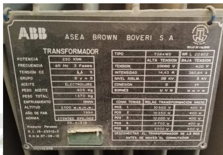
Figura 2: Vera, C. (2017). Placa de Datos del Transformador de Distribución de Tecsups. [Fotografía]. Subestación de Tecsups – Arequipa.
