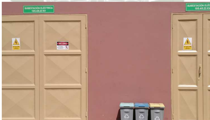
Figura 1: Vera, C. (2017). Vista frontal de la Subestación. [Fotografía]. Subestación de Tecsup – Arequipa.
