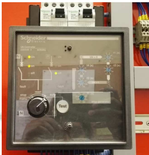
Figura 45: Vera, C. (2017). Controlador Automático de Transferencia UA Controllor de Schneider Electric. [Fotografía]. Subestación de Tecsup – Arequipa.
