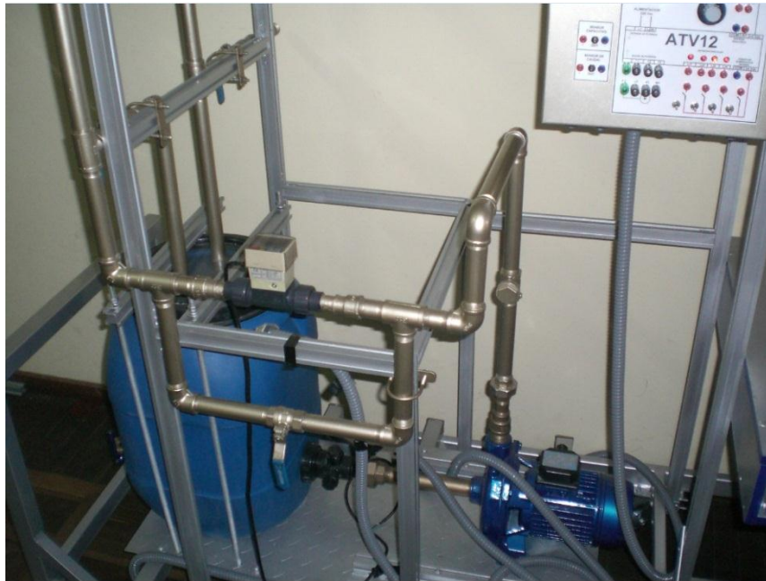
FIGURA No. 115: DETALLE Nro. 2 DEL MÓDULO DIDÁCTICO DE CONTROL DE CAUDAL
