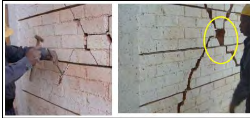
Figura 15: Profundización de las grietas de la albañilería
