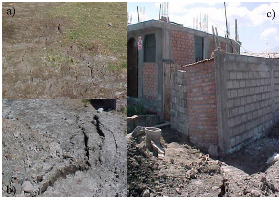
Ilustración 37 a) Agrietamiento de la superficie del suelo. Huaranguillo, Sachaca. b) Grietas en el terreno Urb. Las Magnolias, Lara, Socabaya. c) Inclínación de muro. Urb. Las Magnolias, Lara, Socabaya. Fuente (Yanqui C. , 2001).
