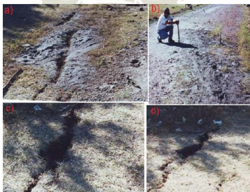
Ilustración 31 Las Lisas, fotos de las grietas debido al terremoto de EL Salvador Fotos: (Palma Ponce, 2003).
