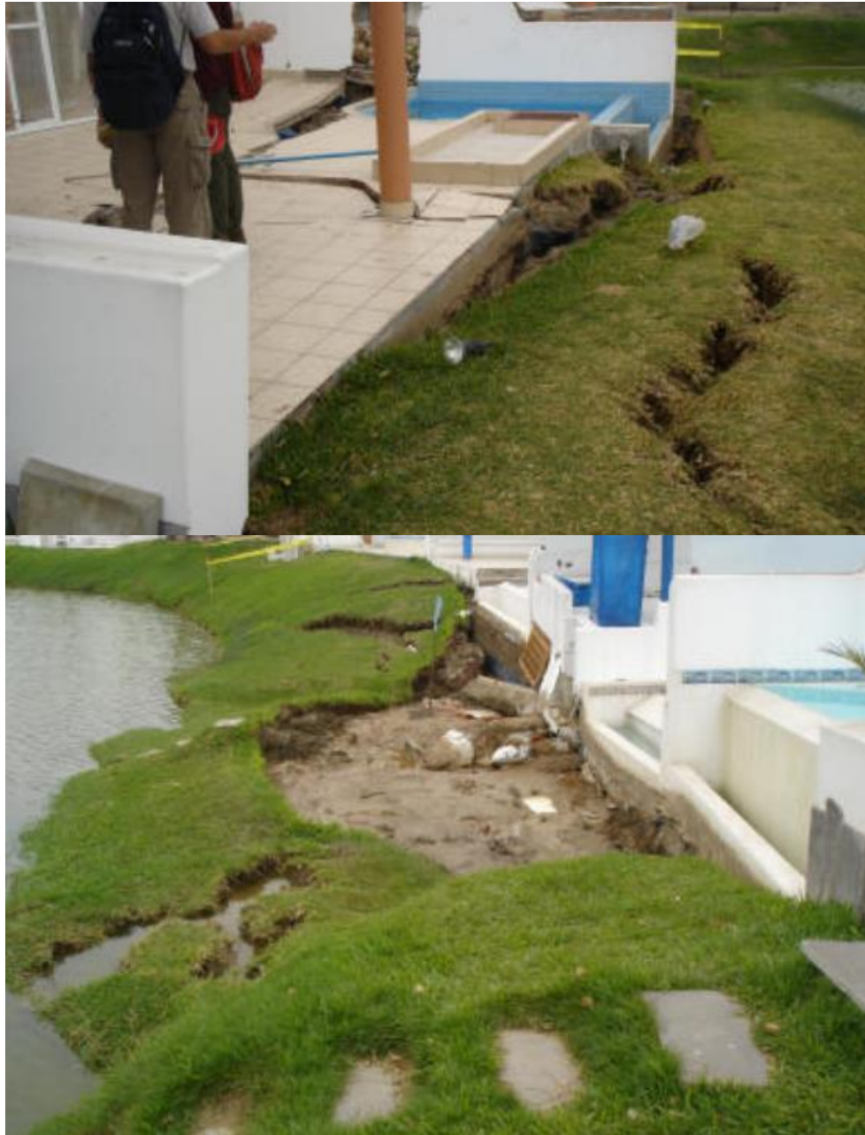
Ilustración 43 Desplazamientos laterales y fallas asociadas a licuefacción en el complejo Las Lagunas. Fuente (Rodríguez-Marek, y otros, 2007).
