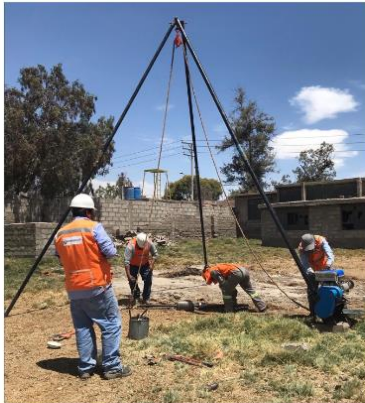
Foto 21: Armado del tripode del equipo de penetración estándar SPT. Fuente: Toma propia
