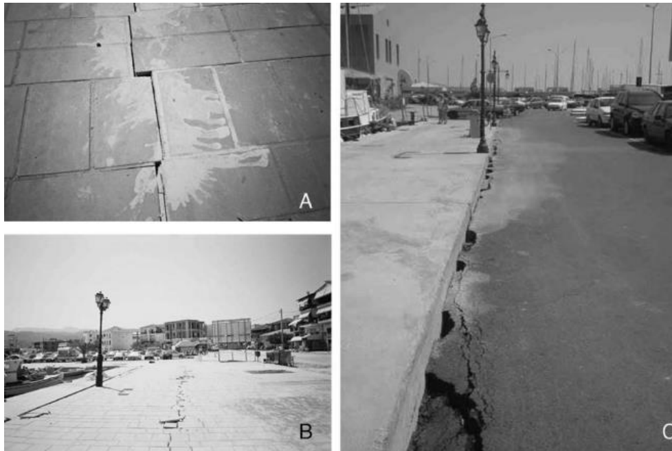
Ilustración 29 Licuefacción del terreno en la ciudad de Lefkada (A) eyección de limo arenoso desde las grietas del suelo, (B) roturas de suelo en la línea costera, (C) desplazamientos horizontales del pavimento y eyección de material limo arenoso. Fotos: Papathanassiou
