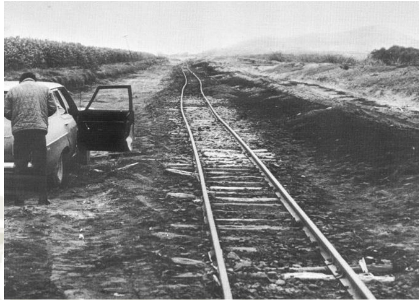
Ilustración 36 Línea férrea de Chimbote-Huallaca dañada como resultado de la compactación diferencial y el desplazamiento lateral de sedimentos no consolidados saturados. Fuente (Ericksen, Plafker, & Fernández-Concha, 1970).
