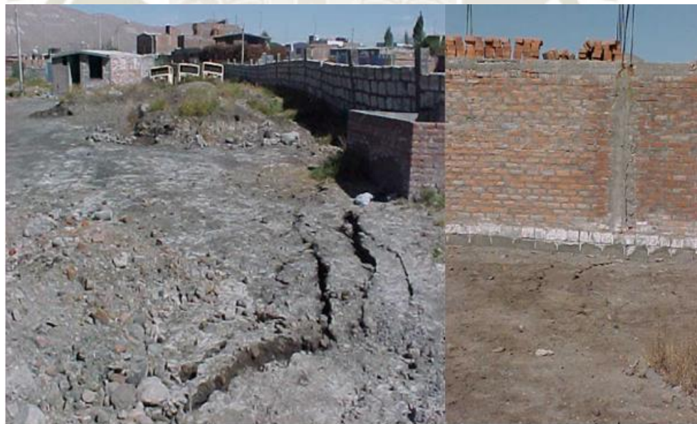
Ilustración 1 Grietas en el terreno de la Urb. Las Magnolias, Socabaya. Fuente (Aguilar Bardales & Alva Hurtado, Noviembre, 2002).
