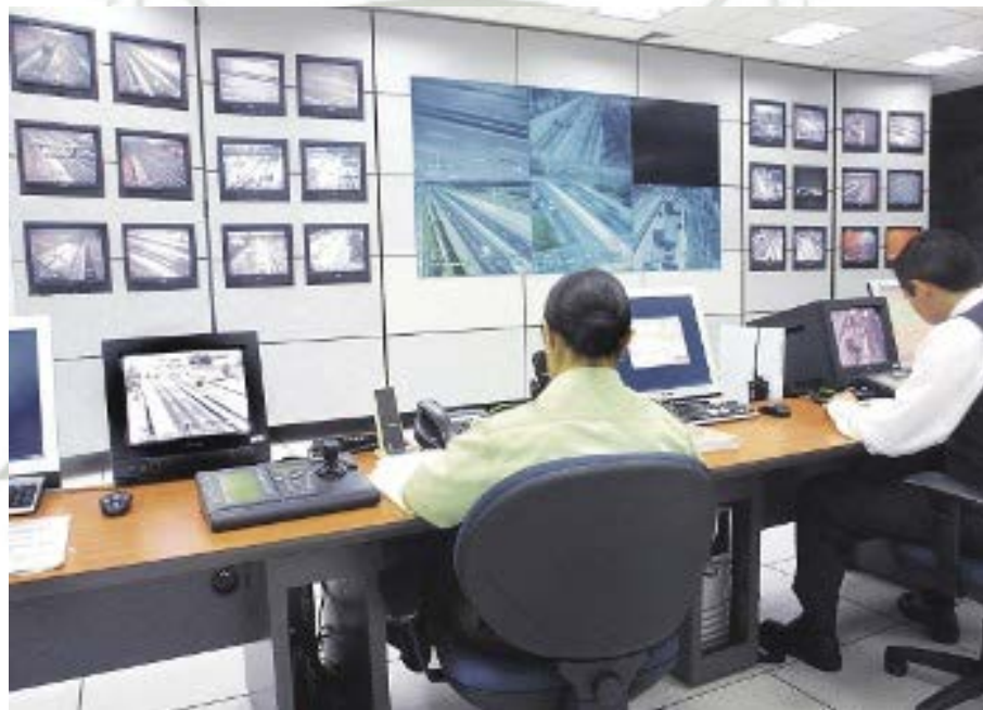
FIGURA 17. CONTROL CENTRALIZADO URBAMÓTICO FUENTE: WWW.GOOGLE.COM
