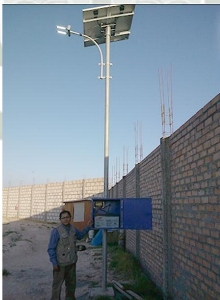
Figura 22 Sistema de alumbrado público solar
