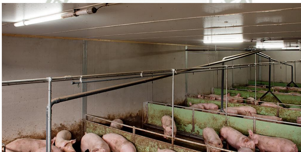
Figura 26 Iluminación para galpón de cerdos
