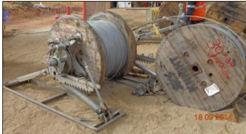
Fotografía 2.6. Bobinas de Cable de guarda. Fuente: Propia.
