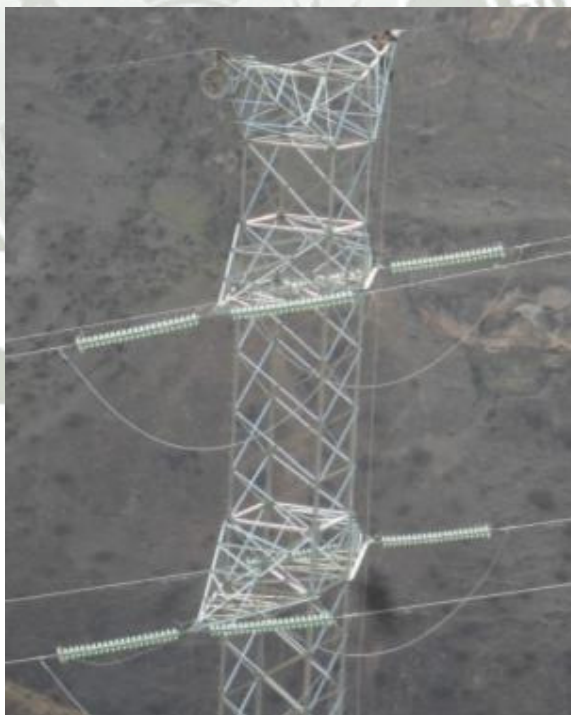
Fotografía 2.10. Cadenas de anclaje. Fuente: Propia.
