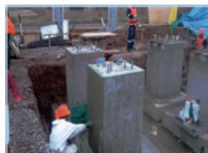
S.E. Quencoro (Pórtico de la Ampliación)
