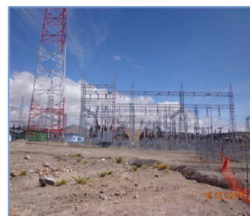
Patio de Llaves 220 kV S.E. Cotaruse
