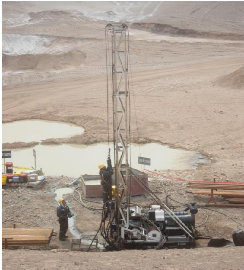
Figura 6. Armado de Kelly para el inicio de perforación. Fuente: adaptación propia en base a la investigación realizada, 2022.
