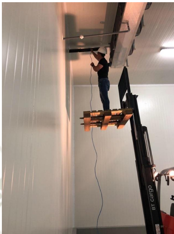
Figura N° 63: Instalación del sensor de temperatura en la cámara.
