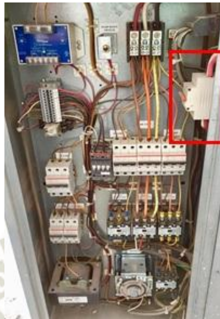
Figura N° 59: Foto del tablero eléctrico del sistema frigorífico original.
