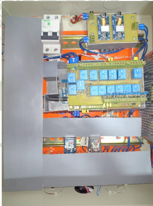
Figura 72 Implementación del Tablero de Control.
