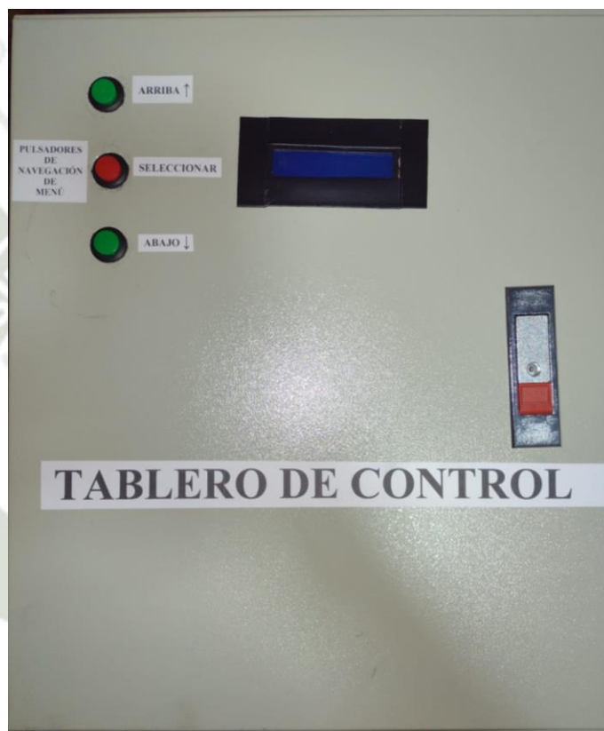
Figura 75 Tablero de Control, Vista externa.
