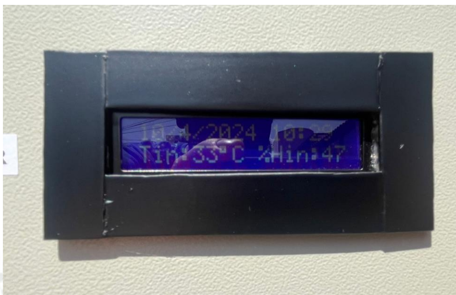
Figura 79 Pruebas de los Parámetros de Funcionamiento del Sistema - 1.
