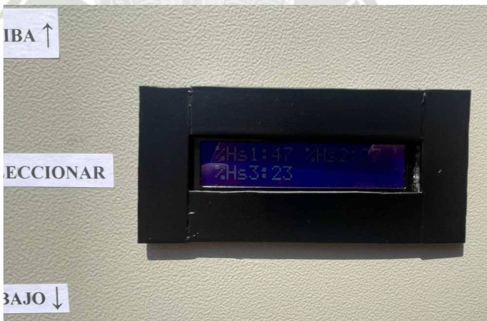
Figura 80 Pruebas de los Parámetros de Funcionamiento del Sistema - 2.
