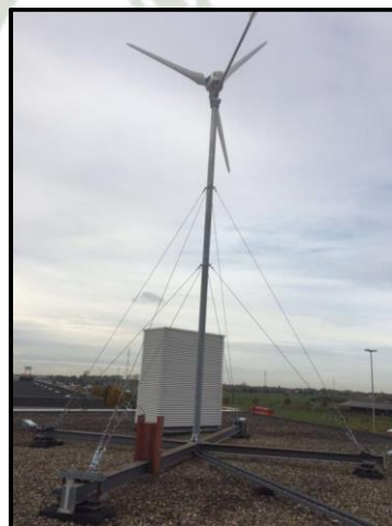
Figura 23. Turbina eólica con torre de acero con arriostre. Fuente: Braun Windturbinen (2018)
