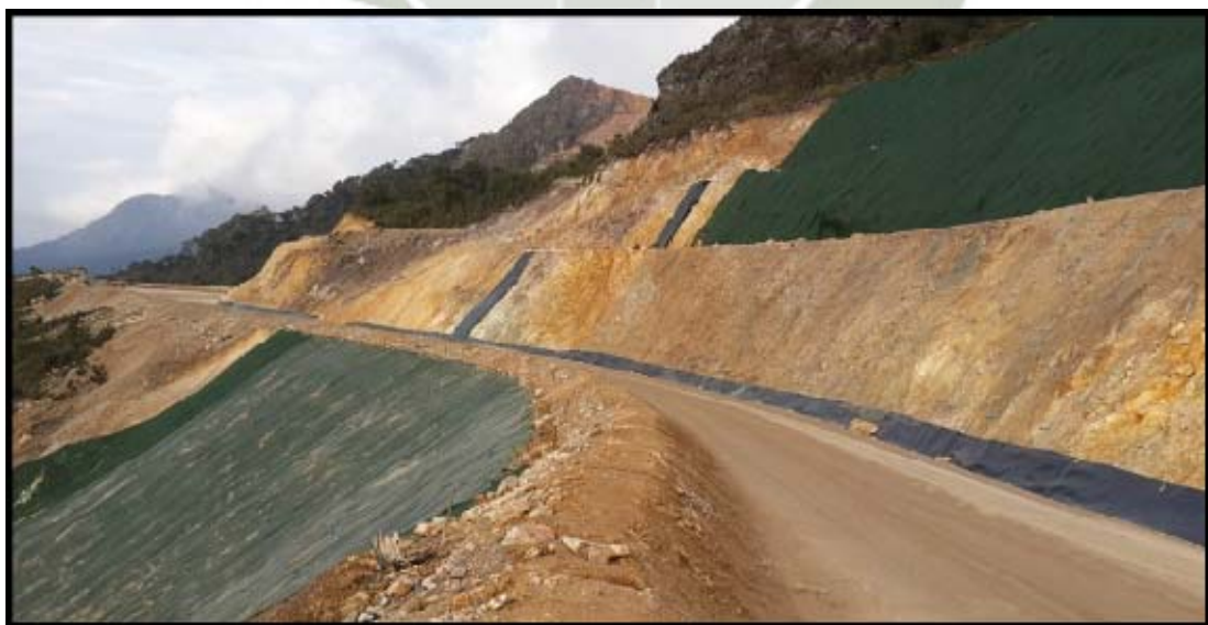
Foto 8: Imagen Talud Progresiva 1+500
