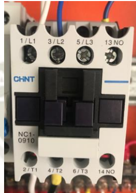
Fig. 48: Contactor de 220V/15A para la motobomba
