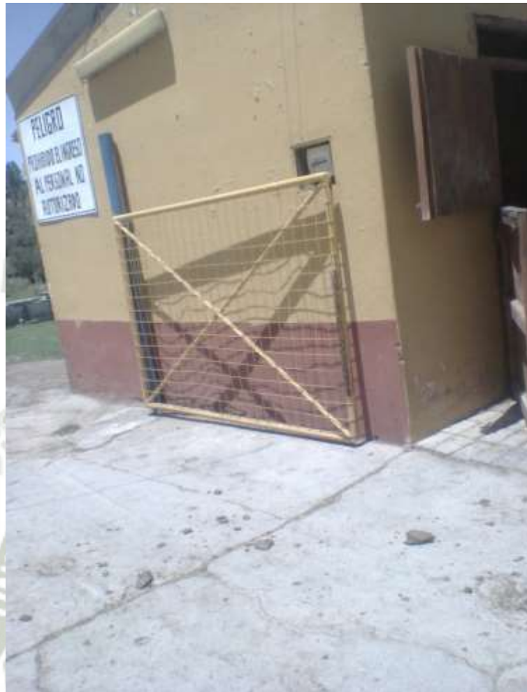
Reja de ingreso a las caballerizas abierta. (Peligro de salida intempestiva de caballos)
