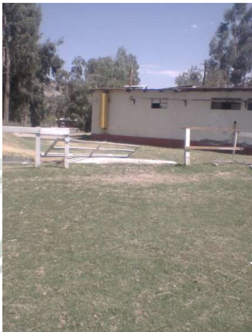
Cerca de ingreso al Picadero N° 1 deteriorada.
