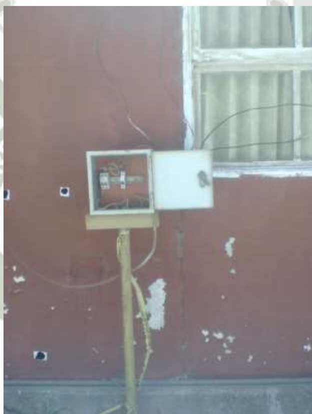
Instalaciones Eléctricas al descubierto.
