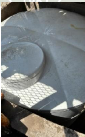
Figura 40 Tanque de lejía al 10%
