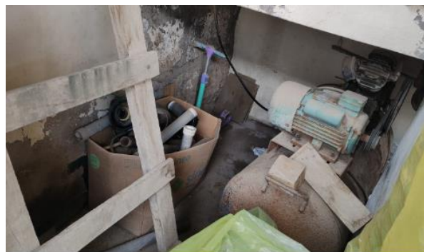
Figura 45 Estado actual de compresora
