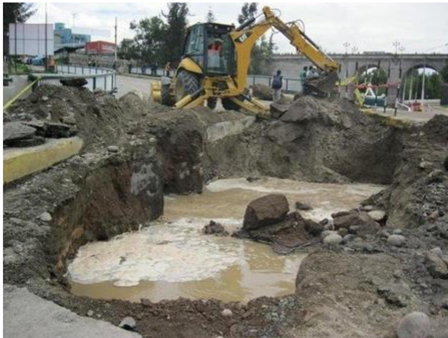
Figura 12. Falla en Puente Bajo Grau
