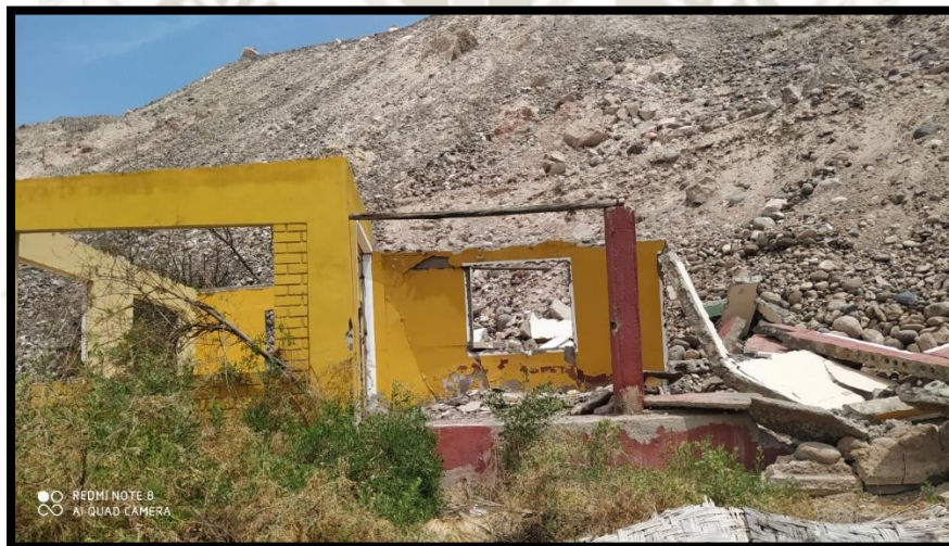
Fotografía 26: Vivienda Destruidas iglesia Pie de la Cuesta
