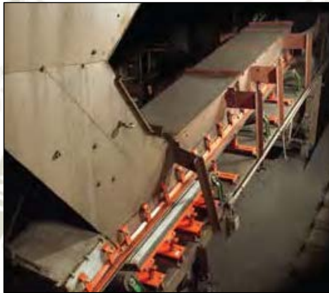
Figura 7. Control pasivo de polvo mediante aumento de zona de asentamiento.
