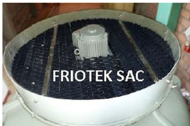
Instalación típica de Eliminadores de Humedad en Torres de Enfriamiento tipo botella
