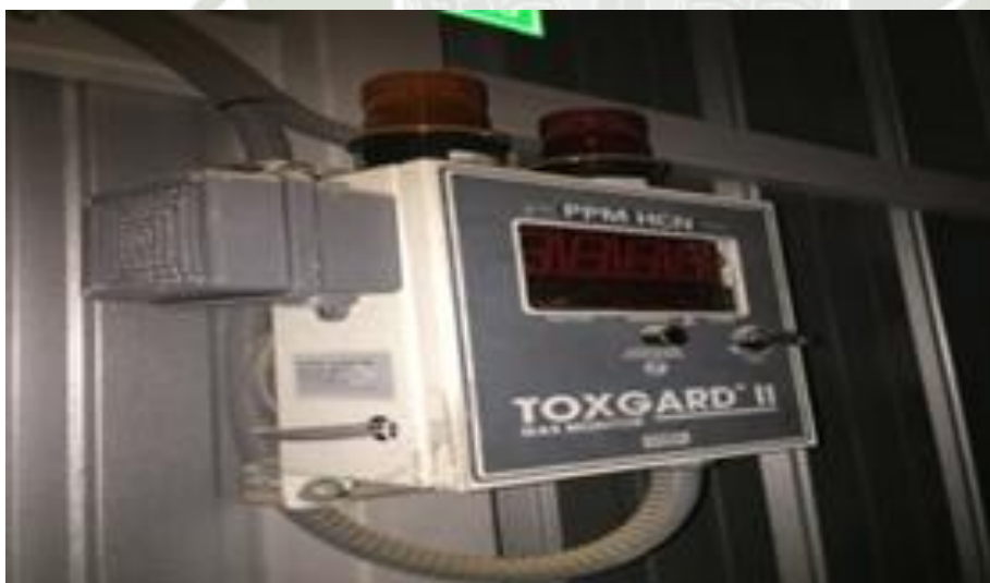
Figura 29 Equipo detector de gases sin energía
