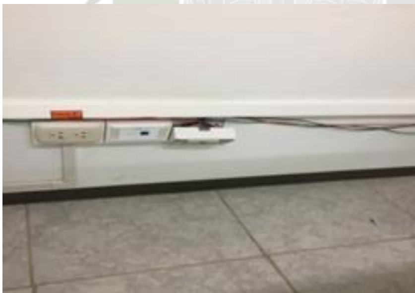
Figura 21 Cables de tomacorrientes expuestos
