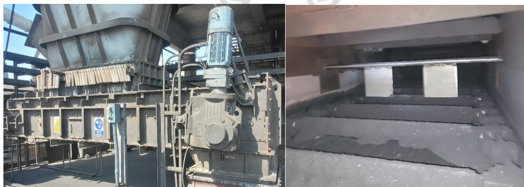
Figura 38 Transportador de cadena y paleta de detección en su interior
