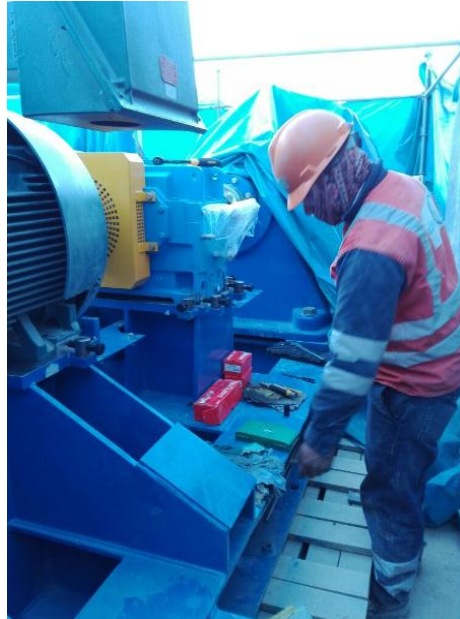
Figura N° 38. Ajuste de piezas en equipos instalados.
