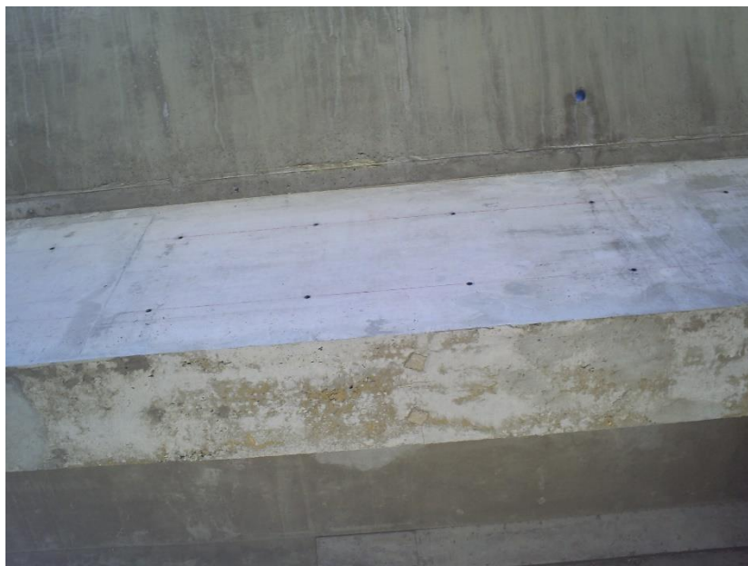
Figura 3.9 Se observa el resane de fisuras realizadas sin autorización de la supervisión.
