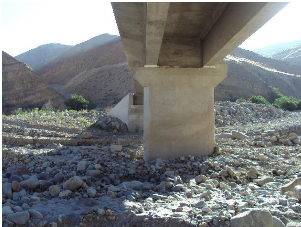
Figura 5.3 Pilar central de apoyo del tipo placa o muro de la subestructura.
