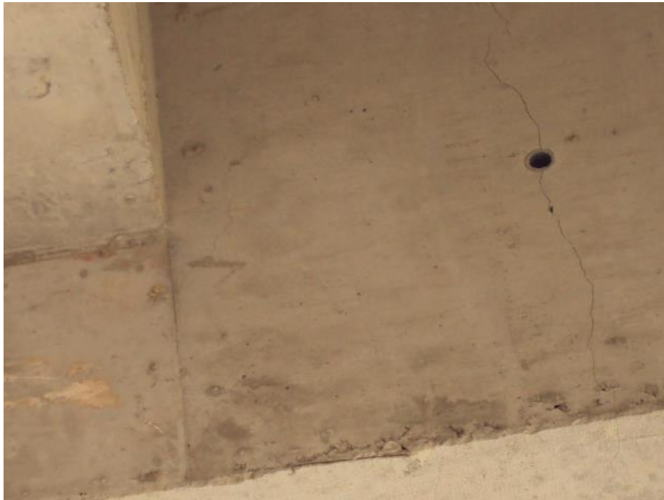
Figura 3.7 Fisura típica por flexión encontrada en varios tramos centrales de 0.10 mm a 0.30 mm (micro fisuras)
