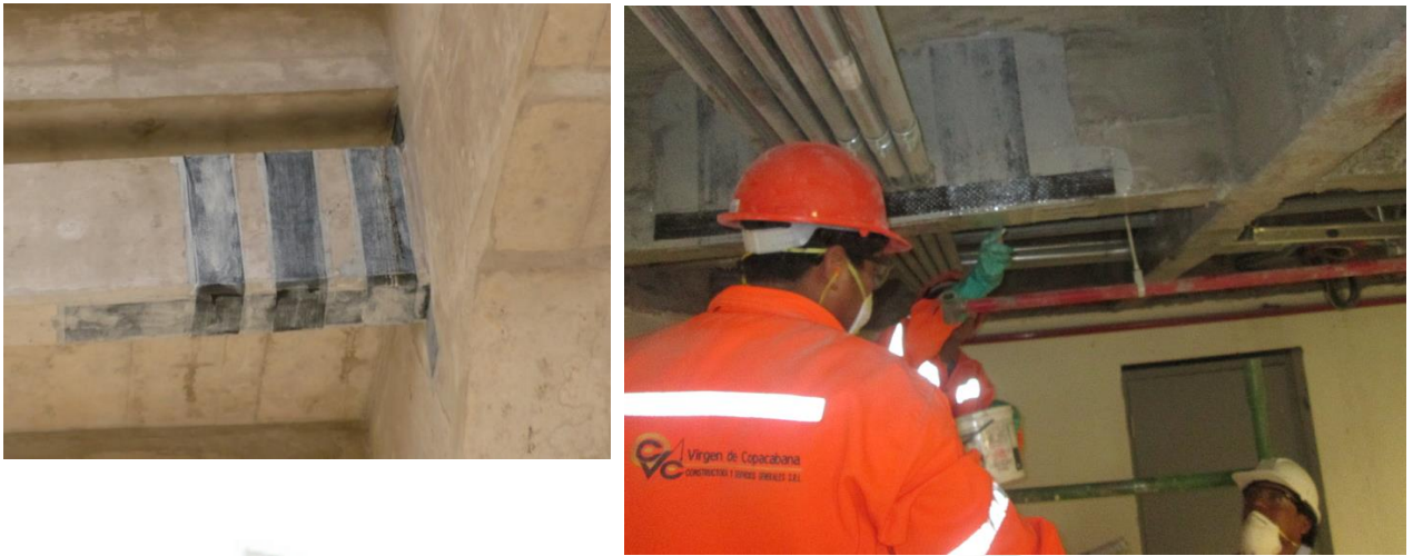
Figura 6.7 Reforzamiento por corte en vigas (cortesía empresa Virgen de Copacabana Constructora y servicios Generales SRL)
