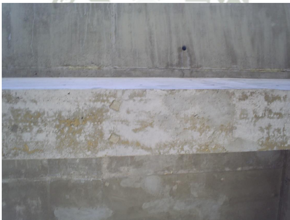
Figura 3.10 Se observa el resane de fisuras en vigas, lo cual perjudica el estudio patológico.
