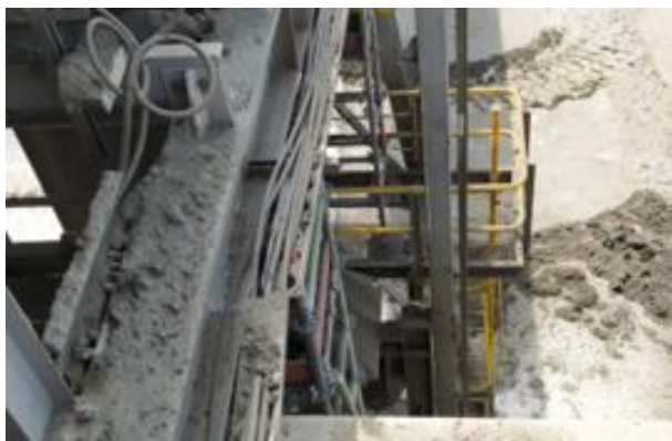
Figura 26 Residuos en estructura de faja transportadora
