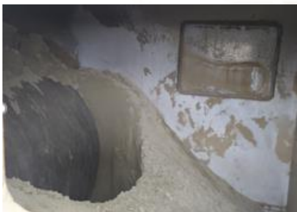
Figura 27 Residuos estructura superior de cono telescópico
