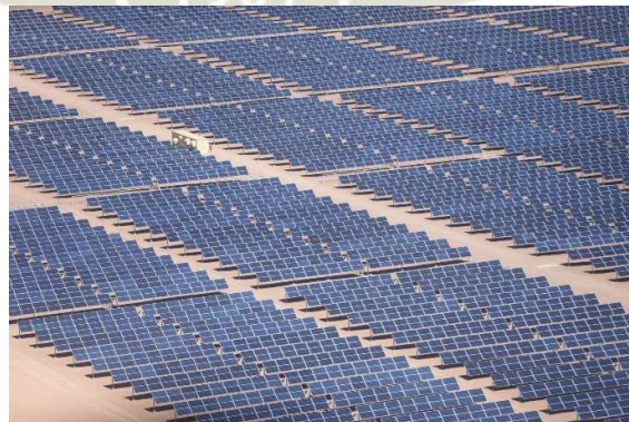
Gráfico 2. 15 – Central solar fotovoltaica Majes Solar
