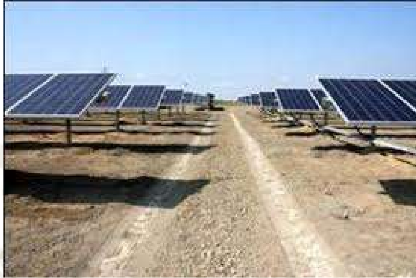
Gráfico 2. 12 – Central solar fotovoltaica Tacna Solar
