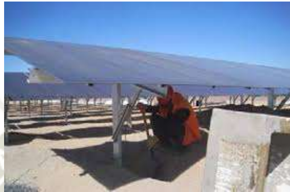
Gráfico 2. 14 – Central solar fotovoltaica Majes Solar
