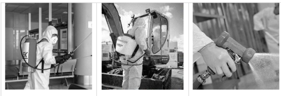
Imagen 08, 09 y 10: imagen referencial de limpieza y desinfección de ambientes y áreas de trabajo en obra.
