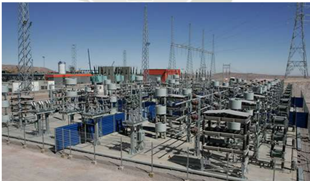
Figura N° 43 Patio de filtros
